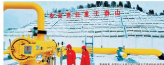
某天然气处理厂，工作人员正在对设备进行日常巡检。
